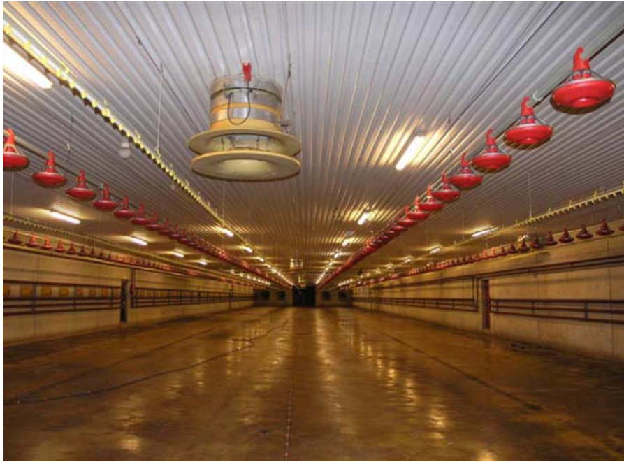
Kuva 2. Sisäkuva broilerkasvatushallista. Ruokintalaitteet on nostettu katon rajaan pesun yhteydessä. Kuvan osastossa poistoilmanvaihtopuhaltimet (7 kpl) sijaitsevat katossa oikealla reunalla (rakennuksen keskiosassa), ja ulkoilmaventtiilit ulkoseinällä vasemmalla (70 kpl). Katossa ilmankierrätyspuhaltimet 4 kpl, ja takaseinällä kesäajan ilmanvaihdon tehospuhaltimet 4 kpl. Toinen osasto on peilikuva kuvan osastosta.
